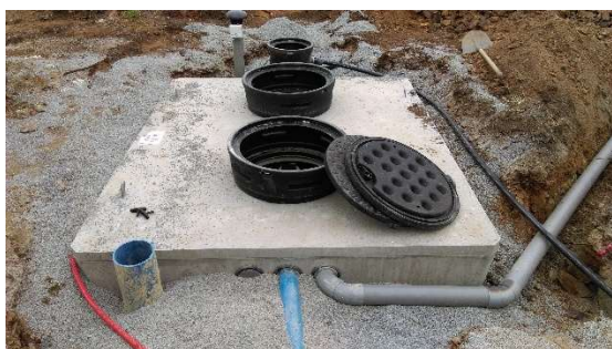
Fosse Toutes Eaux + Filtre Compact 5EH + Pompe
