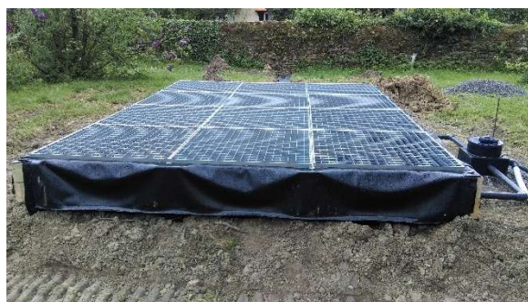
Pompe + Phytoépuration 5EH
